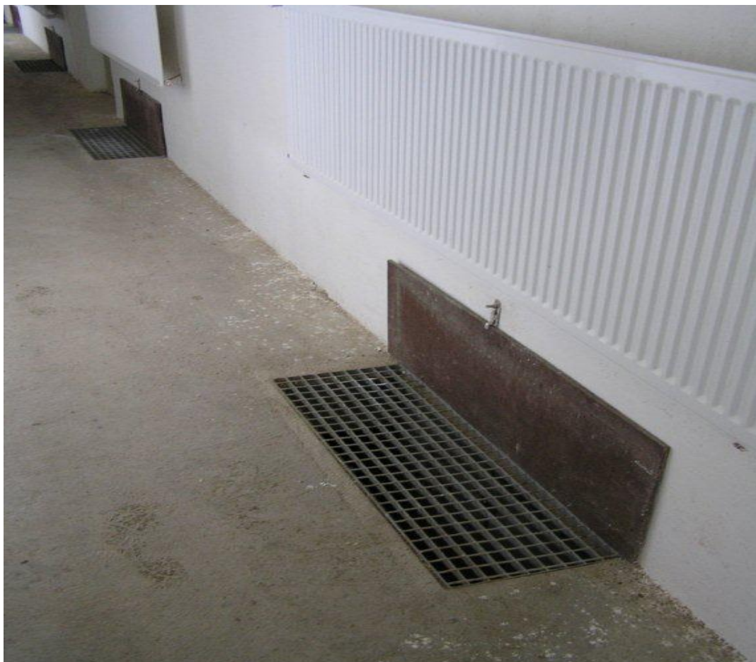
Rys.4 Wyloty powietrza na korytarzu centralnym
